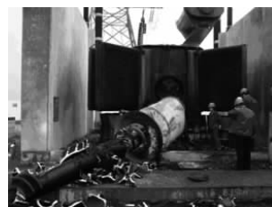
图3 事故现场照片
